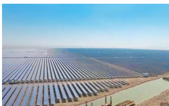
光伏和风电-宁夏太阳山 10MW 地面电站
