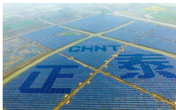
温州乐清 150MW 农光互补地面电站
