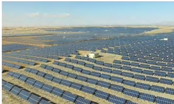
内蒙古库布齐 310MW 沙漠电站
