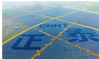
温州乐清150MW农光互补地面电站
